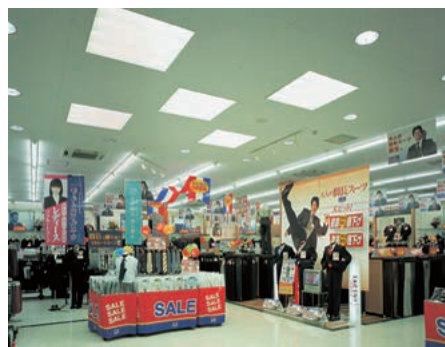
入口周辺の照明
