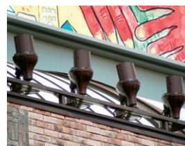
正面側壁面用投光器
