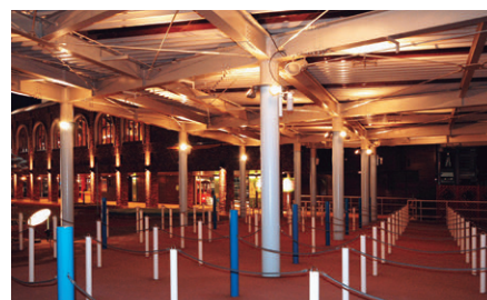
屋根付屋外待ちスペースの照明
