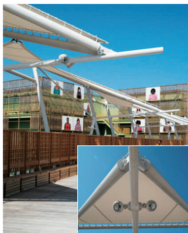
ハロゲンランプ小形スポットライト2台を設置したパーゴラ先端ライト
