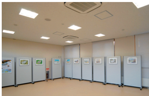
展示ロビーの照明：32Wコンパクト形蛍光ランプ3灯用スクエア器具を設置
