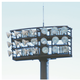
21台の投光器を3段に配置した照明架台部
