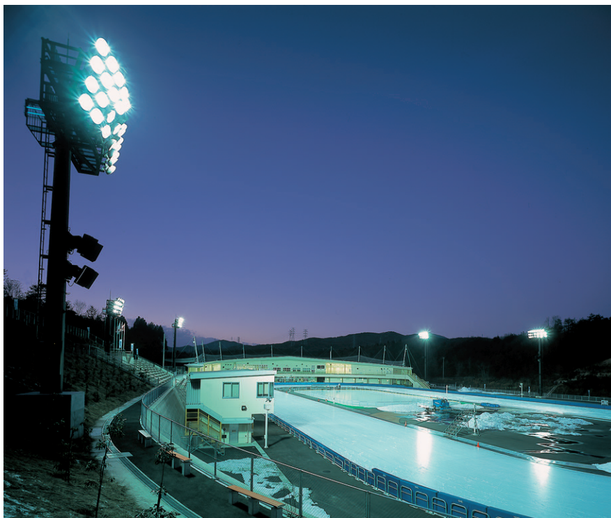
スピードスケートリンク及びサブリンクの照明：1.5kWメタルハライドランプ投光器を設置した照明塔6基をサイド配置
