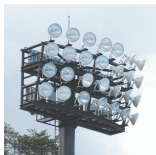
28台の投光器を4段に配置した照明架台部
