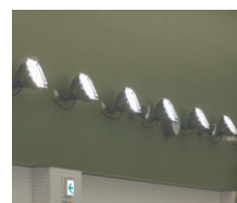
プール両サイド壁面上部へ列状に設置した投光器
