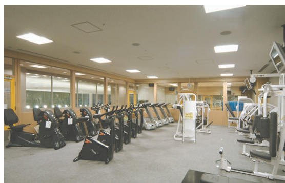
トレーニングルームの照明：55Wコンパクト形蛍光ランプ4灯用埋込器具を整列配置
