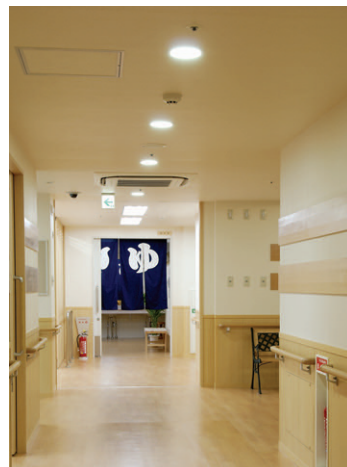
温白色のコンパクト形蛍光灯ダウンライトを設置した1階廊下の照明
