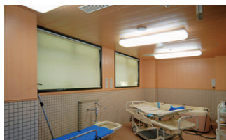
機械浴室の照明：高湿度環境用直付器具カバー付を採用
