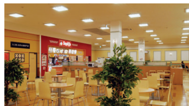
フードセンターの照明：薄形直付スクエア器具（FHP32W×4）を整列配置
