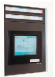
照明制御装置主操作盤
