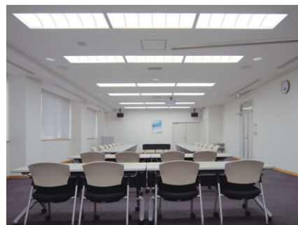
4階会議室の照明：乳白カバー付器具グレースベースライトを3連結にしてライン配置。さらに、3階と同様の調光形ダウンライトを配置して演出シーンに対応
