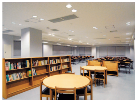
自習室の照明：蛍光灯ダウンライトと照度センサの連動で昼光利用制御
