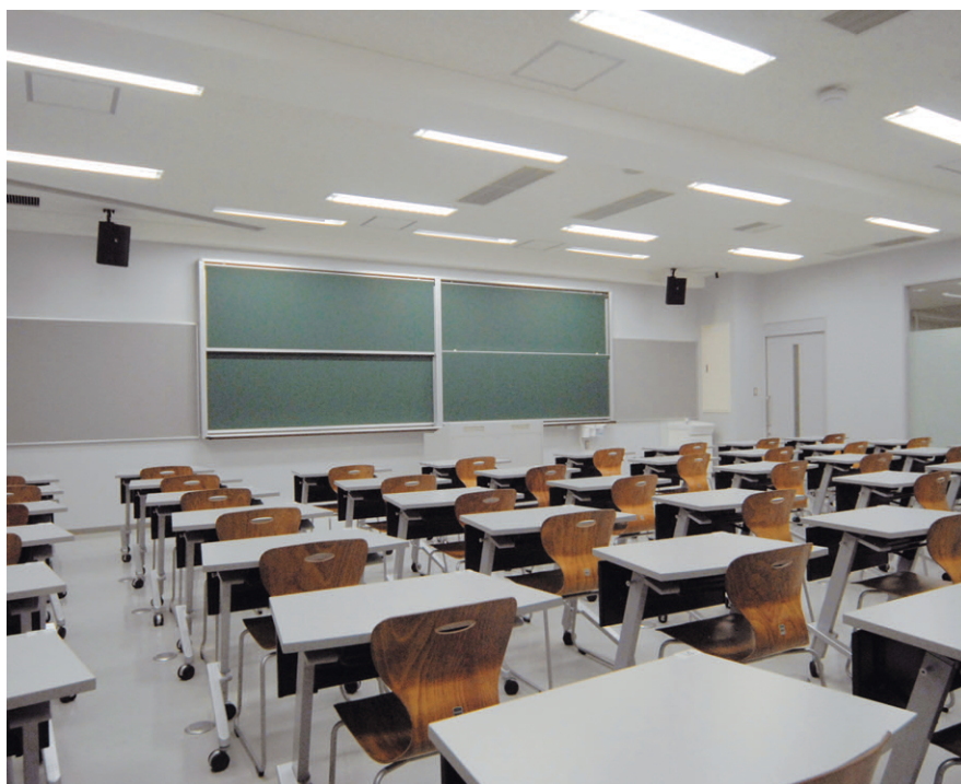
50人教室の照明：32WHiF蛍光ランプ2灯用埋込遮光角制御形器具（バッフル付）を採用
