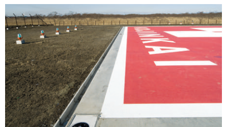
ヘリポート 85Wハロゲンランプ埋込型標識灯(境界灯)と地上型標識灯(境界誘導灯)を設置
