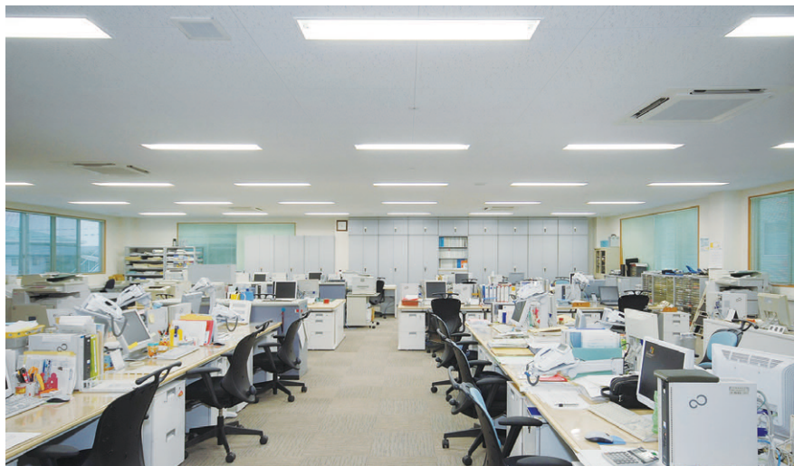
2階事務室の照明 32WHi蛍光ランプ2灯用通信機能付埋込器具による個別制御システム「ティーフレックス」を採用
