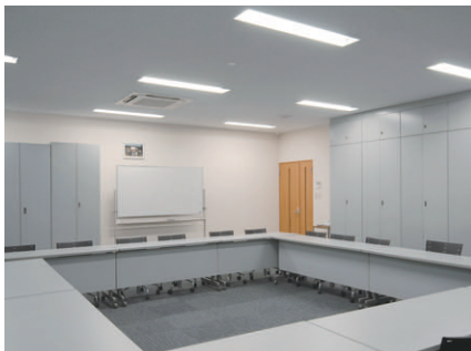
照明個別制御システム「ティーフレックス」を採用している1階会議室
