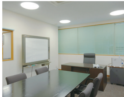
2階役員室の照明 埋込器具セルルーチェを採用
