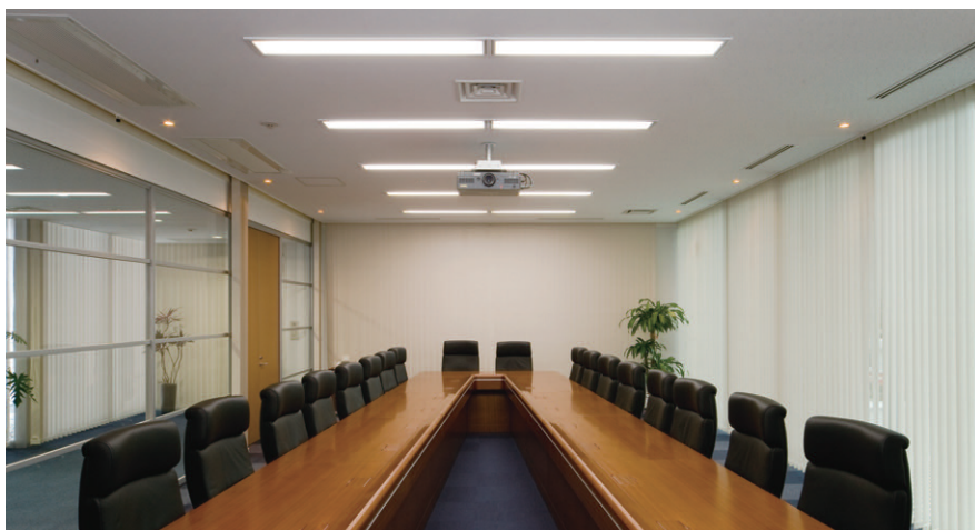
プレゼンテーションルーム V字形の重厚なテーブルを備えたプレゼンテーションルーム。Hf32W2灯用乳白カバー付蛍光灯器具調光タイプを計14台配し、プロジェクタ使用時の調光を可能とし、格調の高い空間に仕上げている
