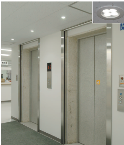
エレベータホールに採用された高効率LEDダウンライト(E-CORE40)
