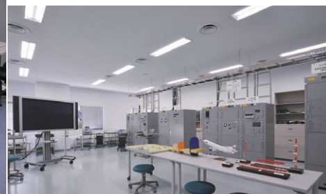
着陸システム実習室の照明 Hf32W2灯用薄型埋込器具初期照度補正器具で省エネ
