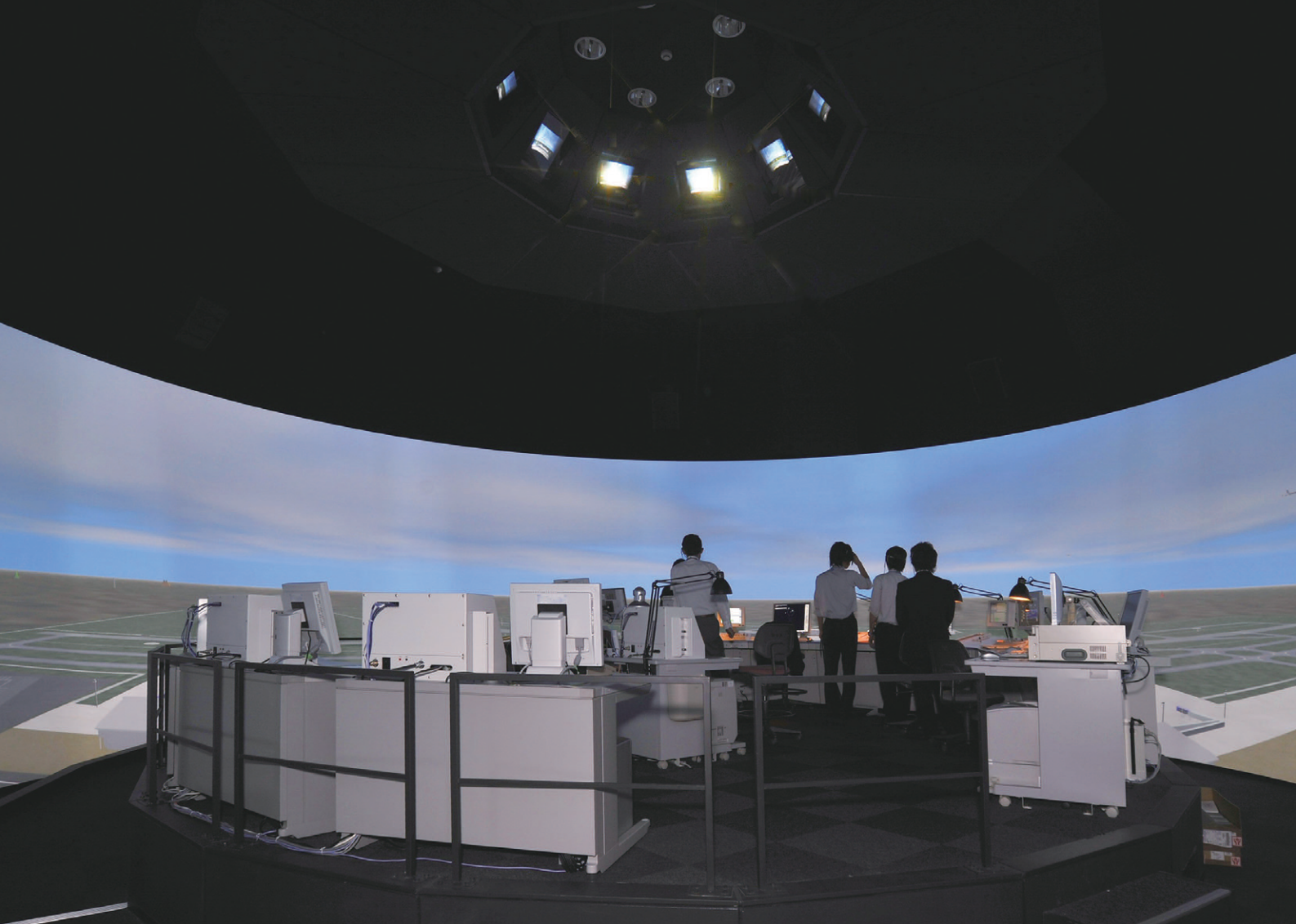
第2飛行場管制実習室 実習室にはFHT42W2灯用と1灯用ダウンライトの調光形を採用
