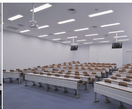
合同教室の照明 Hf32W2灯用埋込器具下面開放形。システム科講義室と同様前1列目は調光形
