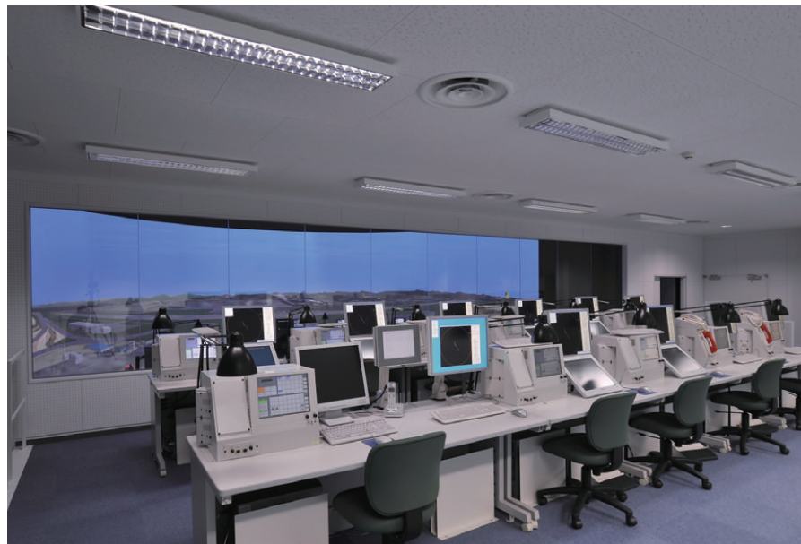
第1飛行場管制実習室 Hf32W2灯用薄形直付器具OAルーバ付を採用
