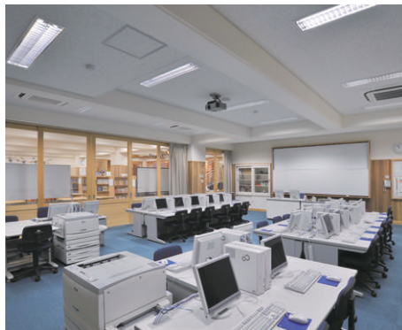
メディア教室・コンピュータ室の照明 32WHf2灯用埋込器具OAルーバ付調光形を採用
