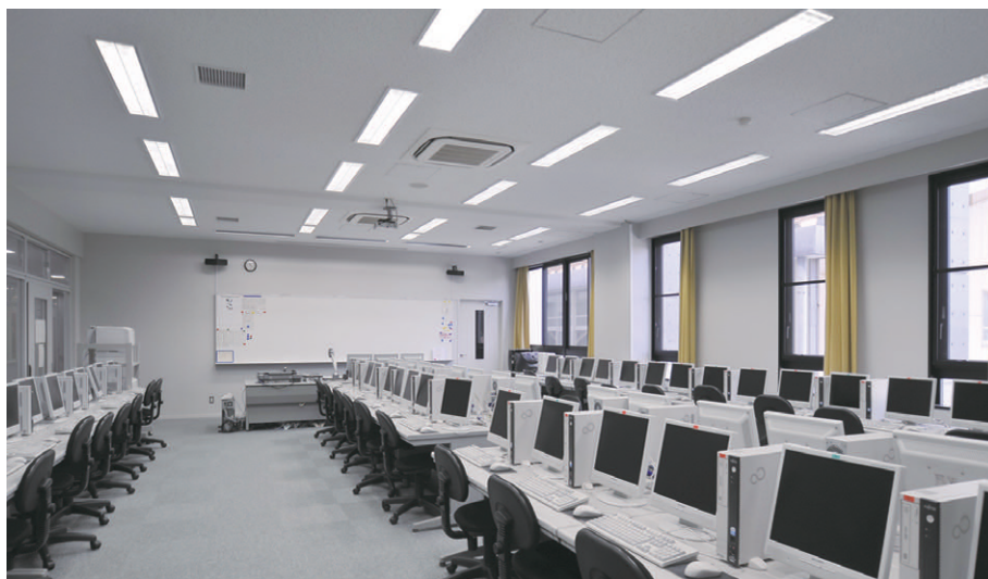
コンピュータ教室の照明 32WHf埋込器具OAルーバ付きを採用し、生徒の目の負担を軽減
