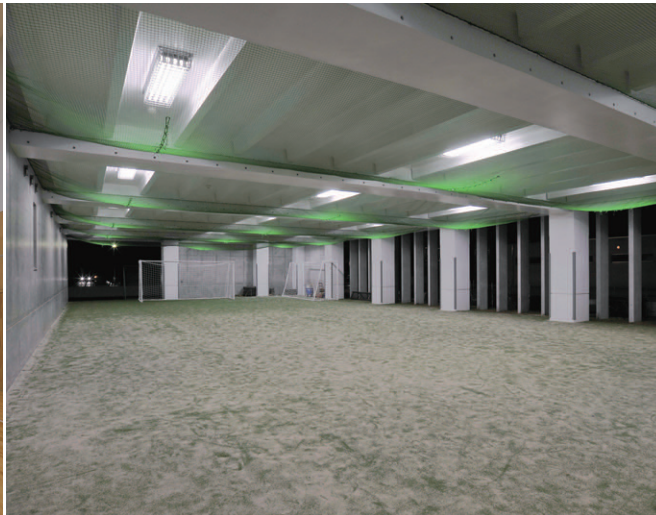
ピロティの照明 トラフ形ステンレス防湿・防雨器具を2連結で計36台配置。下面にガードとネットを設け、器具の腐食・破損を防止
