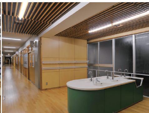
廊下・談話コーナーの照明 談話コーナーは天井木製ルーバ内に1灯用トラフ。廊下は1灯用直付器具をあかり+人感センサで調光
