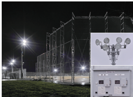
グラウンドの照明 1kWメタルハライドランプ投光器6灯用4基、8灯用3基の13.5m高さのポールを配置し、コイン盤で制御。野球場内野210lx、外野102lx、サッカー場82lxでJIS基準を満足
