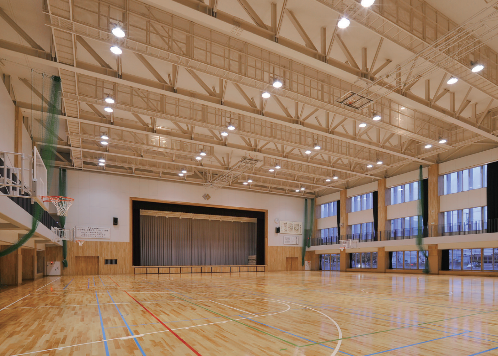
アリーナの照明 ネオセラ250Wガード付投光器 (50~100%調光)を設置し、ランニングコース下の照度センサにより500lxを維持しつつ、初期照度補正制御と昼光利用制御で省エネ
