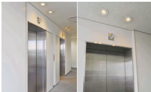
E-CORE〔イー・コア〕LEDダウンライトに更新された5階エレベータホール（1基に対して〔イー・コア〕2台）
