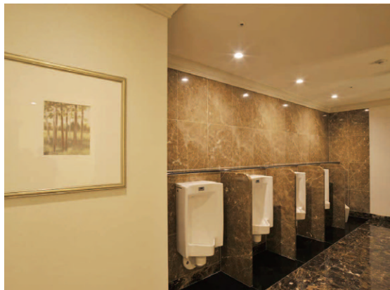
E-CORE〔イー・コア〕LEDダウンライトに更新された15階男性トイレ
