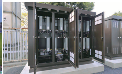
照明塔安定器・分電盤
