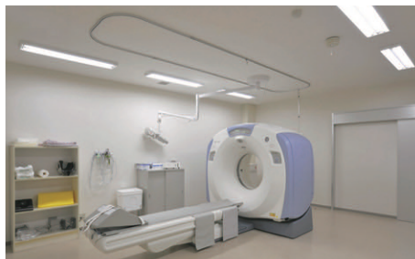
CT室の照明 遮光角制御タイプの薄形直付器具を採用
