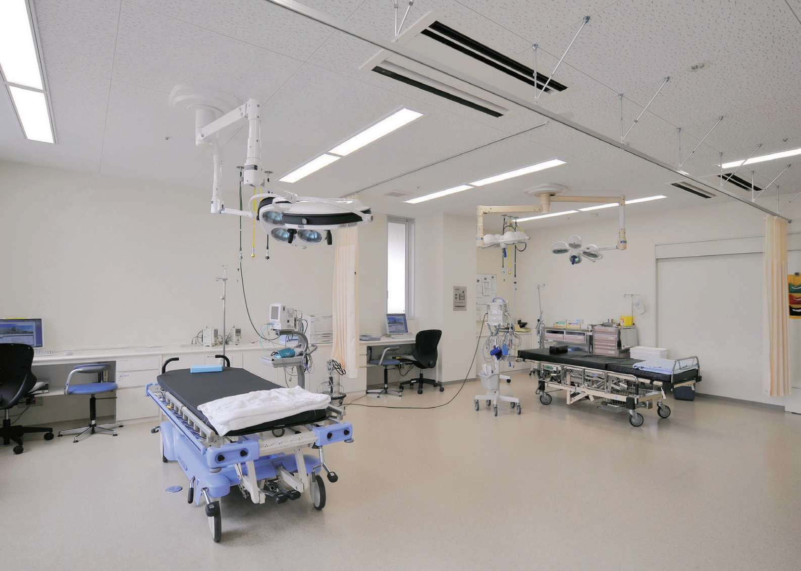
救急処置室の照明 FHF32W×2灯用埋込カバー付器具を無影灯の両側に配置。医療環境に最適な明るさを確保
