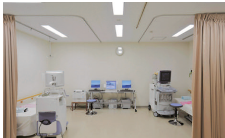
エコー室の照明 FHF32W×2灯用埋込カバー付器具を採用。 ベッド上は調光形 (25~100%) を使用
