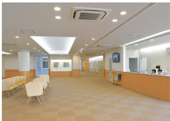
折上げ天井に間接照明を施した会計窓口周りの待合室の照明
