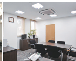
理事長室の照明 FHP32W3灯用深形埋込カバー付を均等配置
