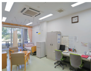
医務室の照明 FHF32W2灯用埋込器具乳白カバー付初期照度補正タイプを採用
