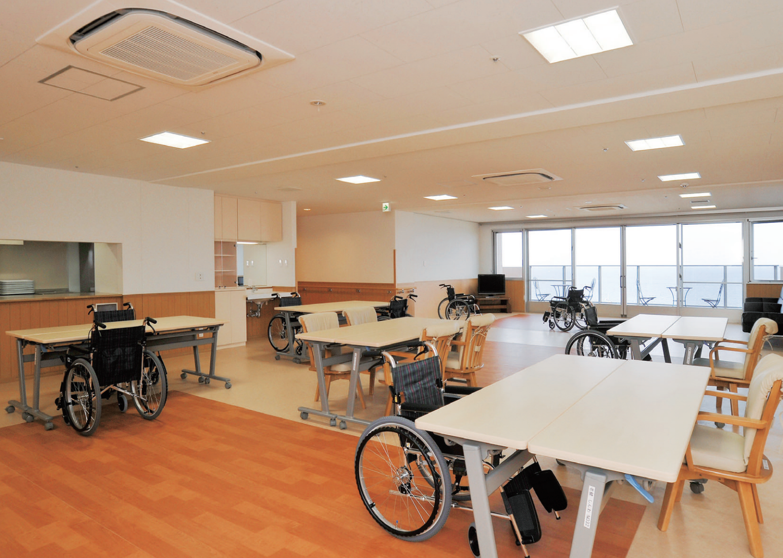
食堂およびレクリエーション・談話室の照明 FHP32W3灯用埋込スクエア器具バップル付を採用。眩しさを軽減し、潤いのある照明環境を創出
