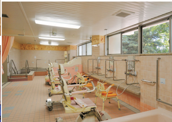
特別浴室の照明 高湿度環境用直付器具カバー付を設置
