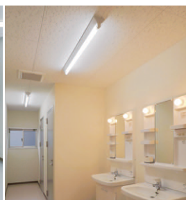
トイレ・洗面所の照明
