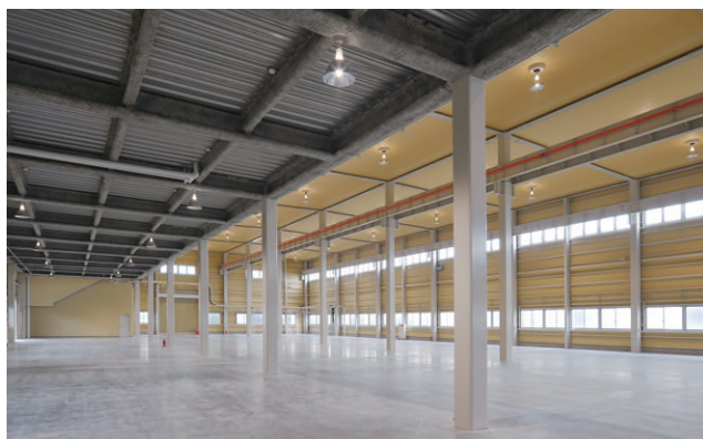
230WHL-ネオセラ高天井用反射笠器具が設置された天井高6mの作業エリアから天井10m高さの作業エリア方向を望む
