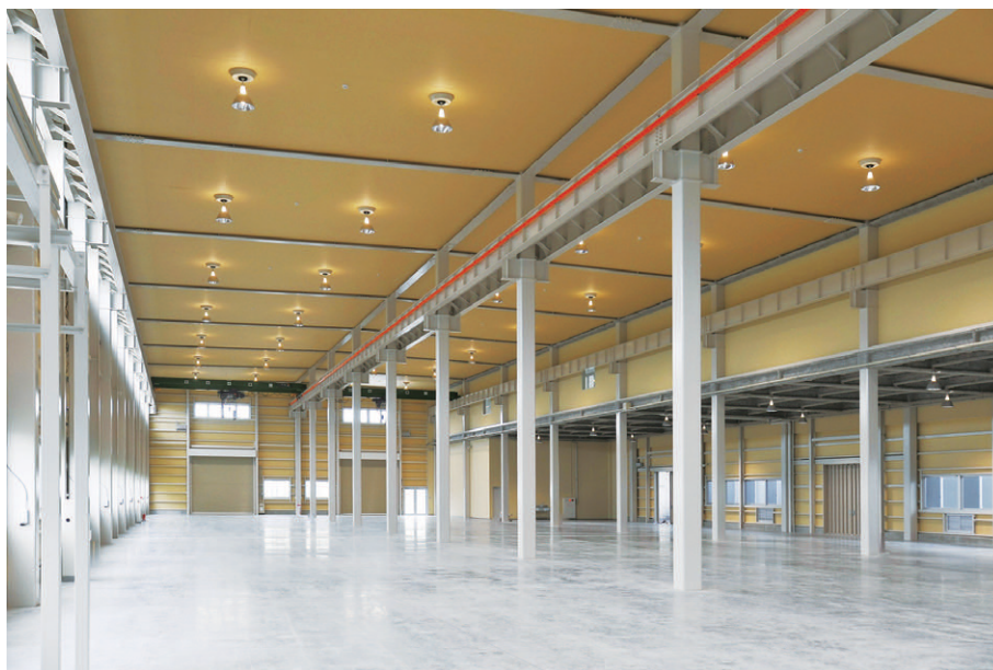
10m高さの天井に均等に設置された360WHL-ネオセラ高天井用反射笠器具(電動昇降装置付)
