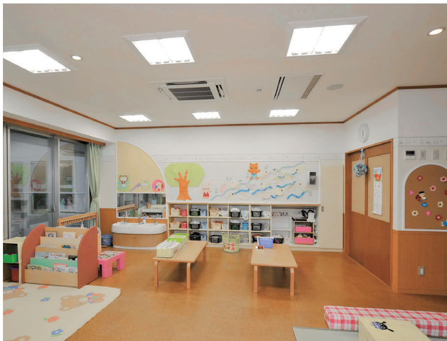
幼児室の照明 32Wコンパクト形蛍光灯ランプ4灯用スクエア器具とネオボールZダウンライトを配置
