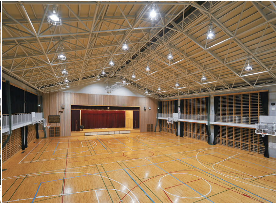
体育館の照明 400Wメタルハイドランプ高天井用反射笠器具（電動昇降装置付）を傾斜天井に左右対称配置
