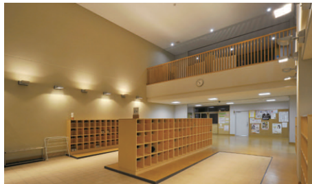
150WCDMアップライトで壁に照射させて間接照明とした昇降口の照明
