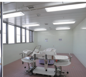
機械浴室の照明 直付防湿形乳白カバー付器具を設置
