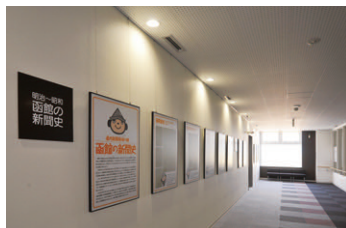
3階見学コースのLED照明
