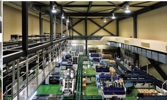
発送部には高効率なHIDランプ反射笠器具を使用し快適な作業環境を創出
