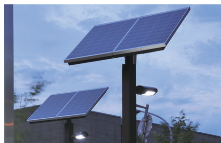
屋外の出入口周辺に設置したLEDソーラーライト
