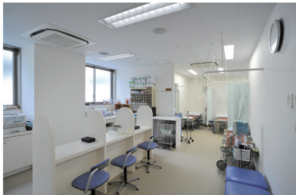
遮光角制御器具による点滴室の照明
