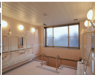
小形シーリングライトによる一般浴室の照明
