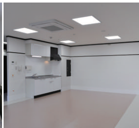
3灯用スクエア器具採用のデイルームの照明
