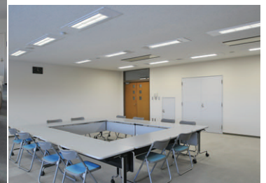
LEDベースライトをリニューアプレートにセットして更新された一般会議室
