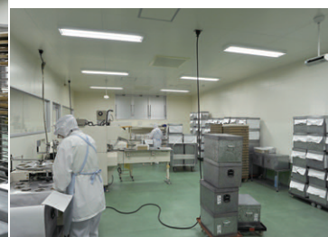
クリーンルーム用器具を採用した2階包装室の照明
