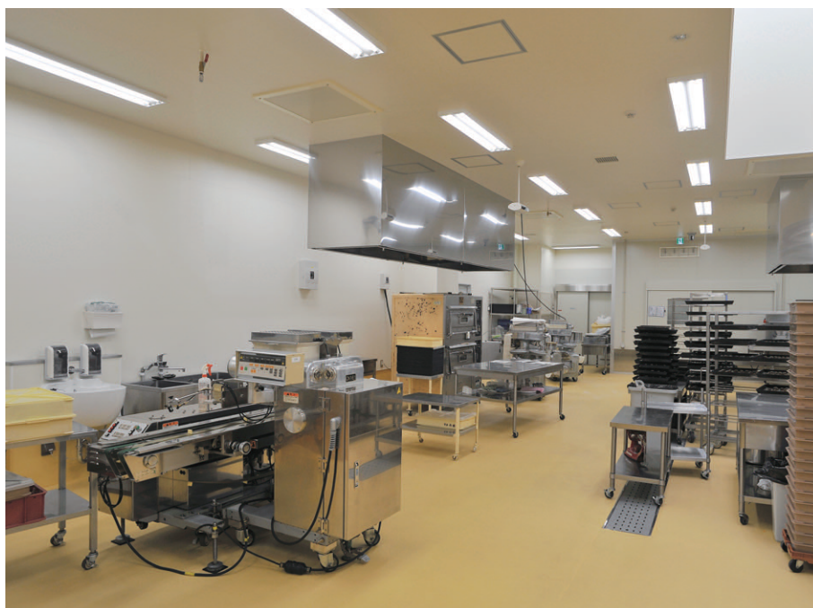
1階製造室の照明 高出力タイプの32WHf蛍光灯2灯用直付器具を整列配置
