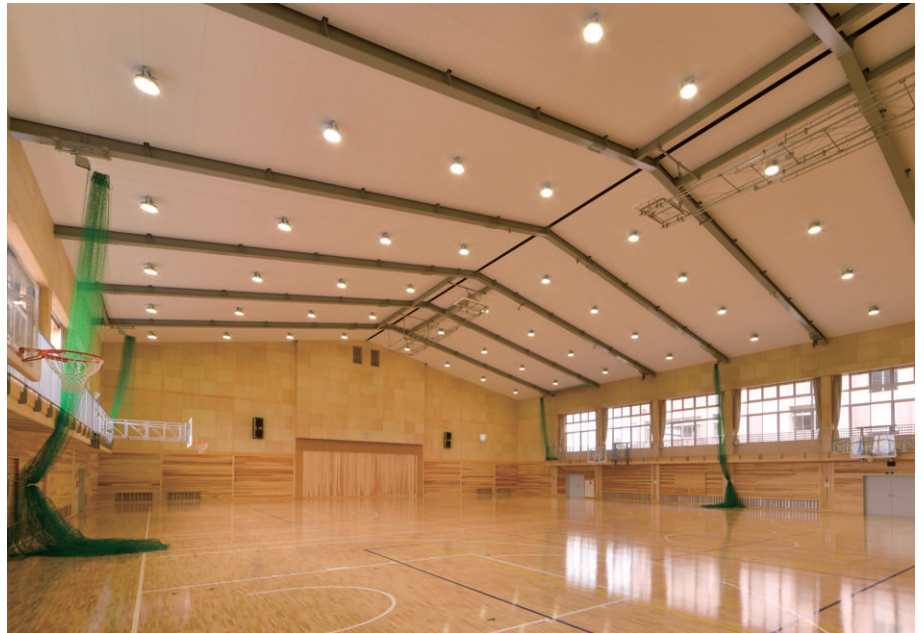
1階アリーナの照明 平均消費電力200WのLED高天井器具を切妻天井に分散設置。器具下面には器具用部品ガード+拡散カバーを装備し、落下防止ワイヤも設置
