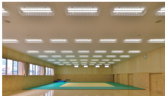
2階武道場には一体形LEDベースライト薄形タイプを整列配置
