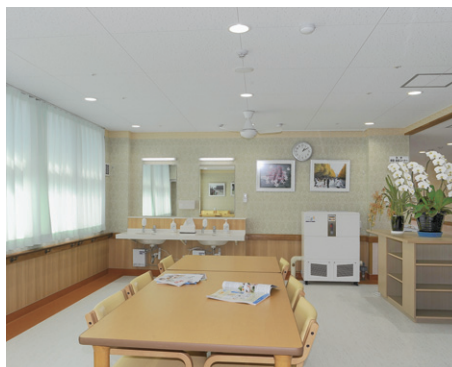
ショートステイの食堂ホール 拡散光のLEDライトエンジンダウンライトを採用
