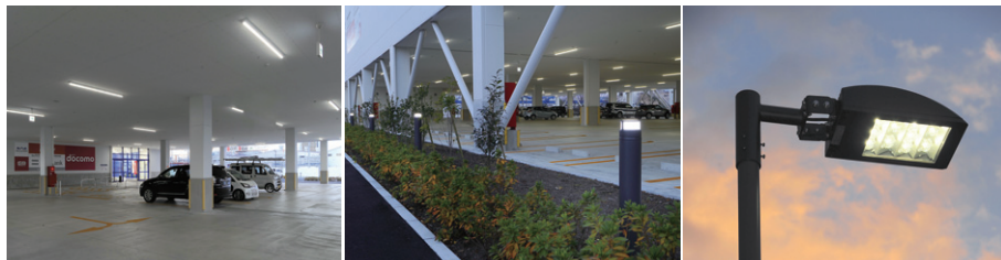
一体形LEDベースライトスリムタイプ採用の駐車場ピロティの照明
