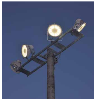
駐車場中央部から広範囲を照射するLED投光器4灯用照明ポール
