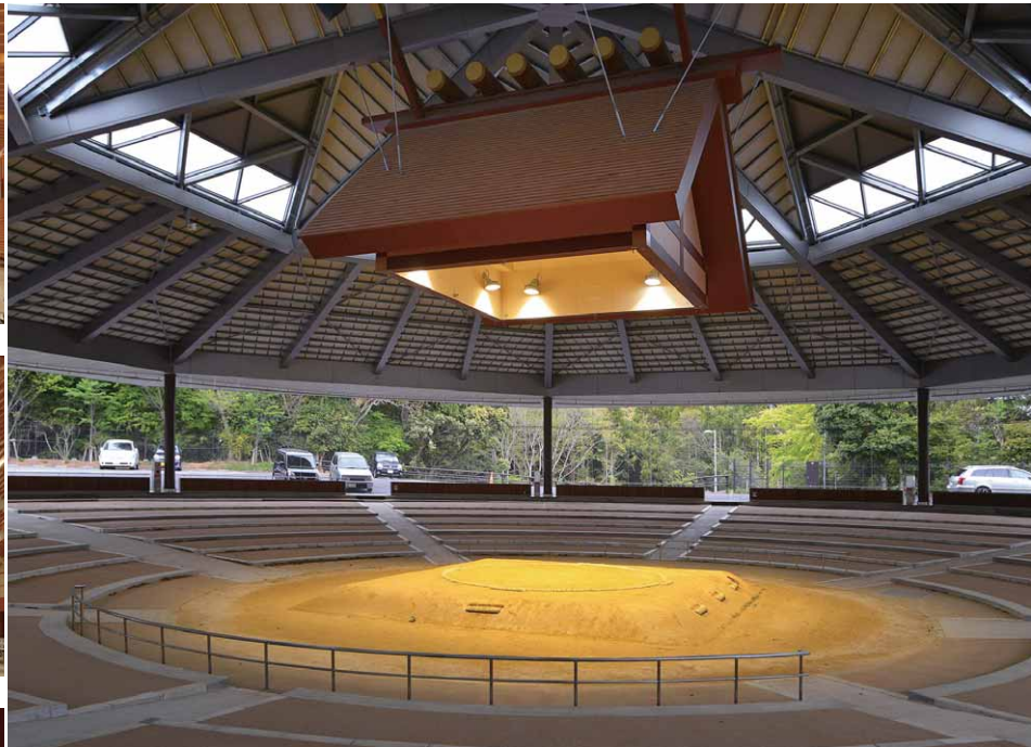
相撲場の照明 吊り屋根内にLED投光器を8台配置し、土俵を明るく照射
