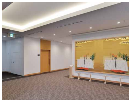
3Fエントランスホールの直管形LEDベースライトによる建築化照明とLED一体形ダウンライト
