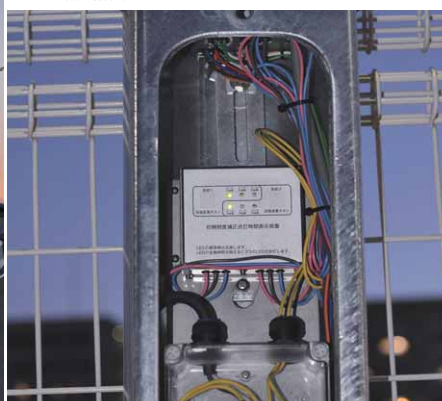
電源装置には初期照度補正点灯時間表示装置を導入
