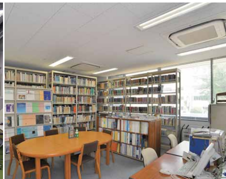
一体形LEDベースライトストレートタイプを設置した図書室
