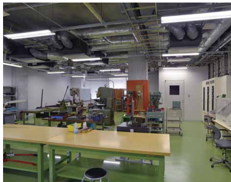
工作室の照明 LEDベースライト薄形タイプ調光形をレースウェイに設置
