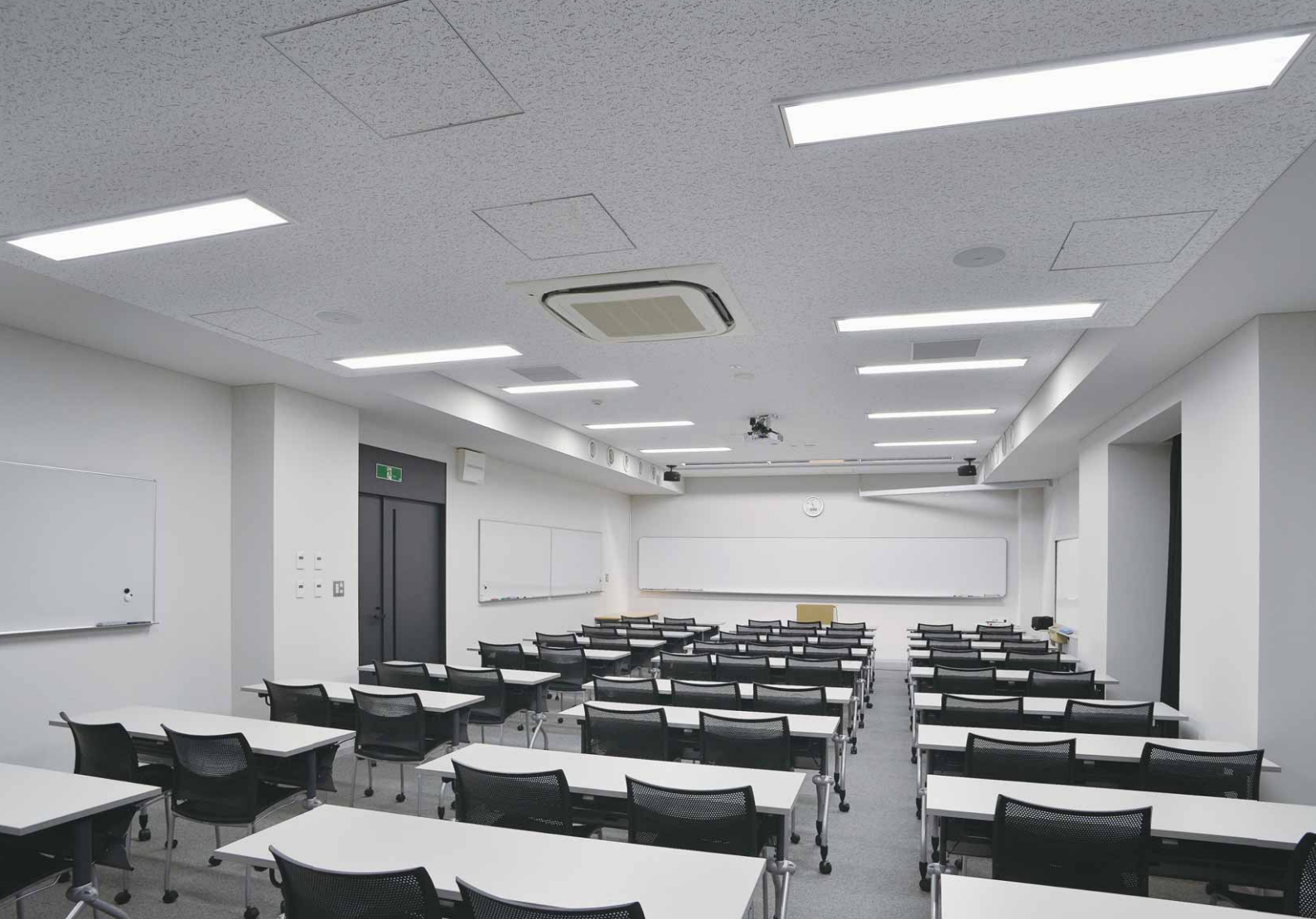
講義室の照明 ベース照明には一体形LEDベースライトストレートタイプ調光形(約5%~100%連続調光)を、黒板灯には照射角切換可能形の直管形LEDベースライトを設置。ベース照明はあかり・人感センサーで不在箇所の消灯が行える
