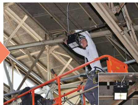
更新後のLED高天井器具
