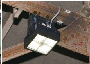
トラスに直付けしたLED高天井器具
