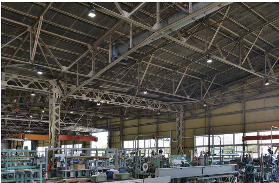
400W水銀ランプ高天井用反射笠器具からLED高天井器具角形昼白色に更新した工場内
