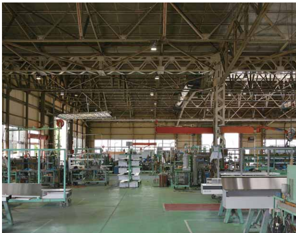
LED高天井器具に更新された工場内通路周りの様子
