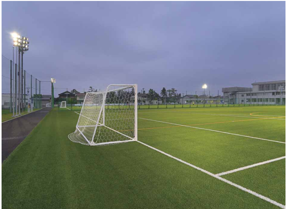
1面当たり高さ13.5mの照明柱4基にそれぞれ12台のLED投光器を設置
