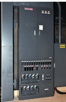
持込照明用電源盤（舞台奥）
