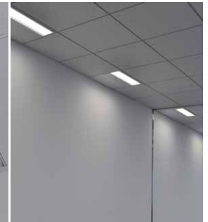
エレベーターホール側には1灯用LEDシステム天井用グリッド照明器具を配置
