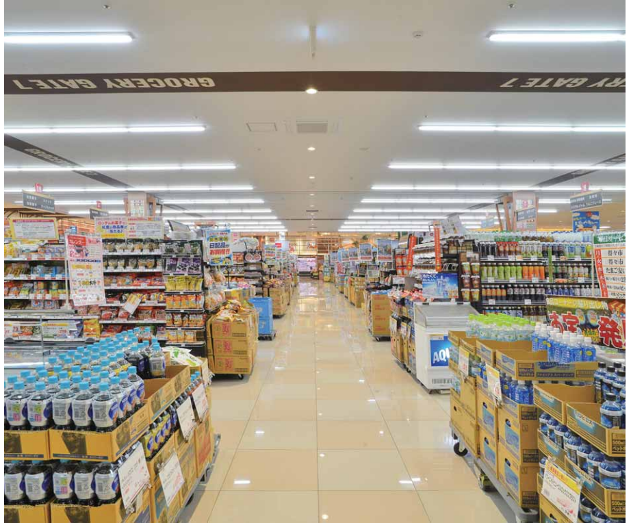
LEDベースライトAQシリーズ直付形が均等にライン配置されているグロッサリー売場の中央回遊通路を望む
