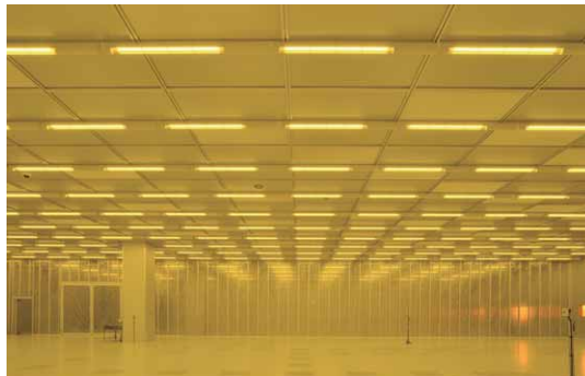
均等配置したLEDクリーンルーム用器具を水平面方向から望む
