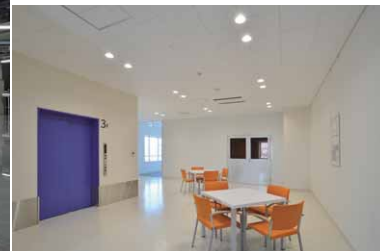
休憩スペースにはLEDライトエンジンダウンライトを設置
