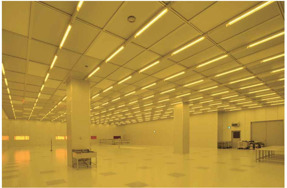
クリーンルームに採用された特注品のLEDクリーンルーム用直付器具 イエローランプ使用で清浄度クラス100適合品
