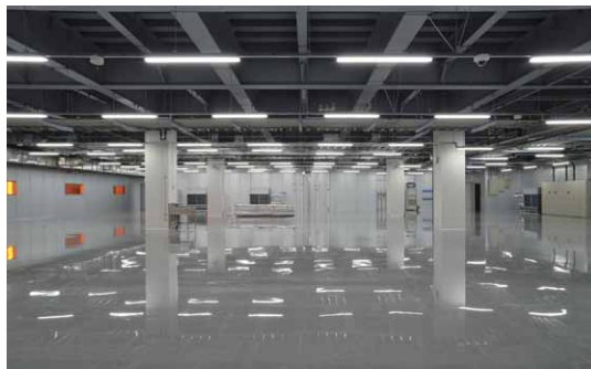
2階機器設置スペースに採用したLEDベースライトAQシリーズ直付器具
