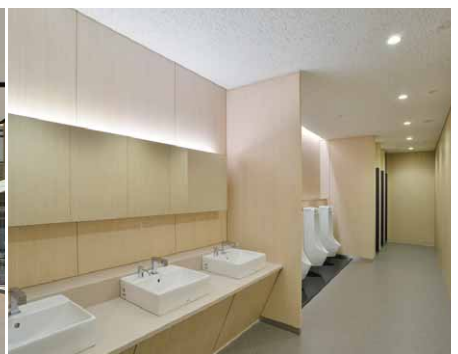
洗面所内はLED間接照明、トイレ内はLEDダウンライト(人感センサーとの連動でON/OFF制御)
