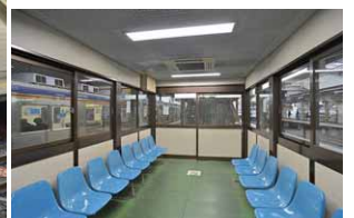
ホーム内にある待合室のLED照明
