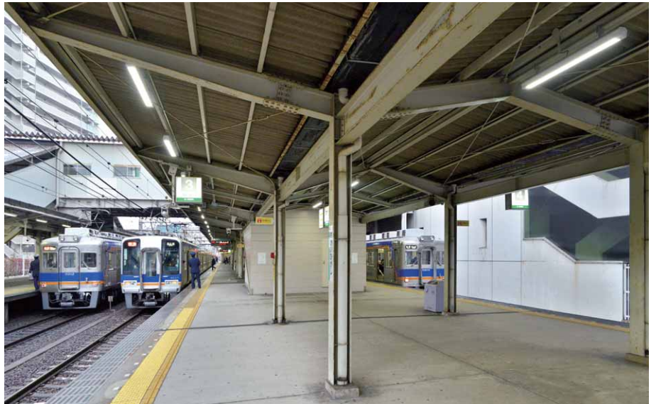
プラットフォーム照明に採用した一体形LEDベースライト直付防雨軒下用(特注器具)
