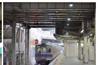
高天井部分に配置したLED高天井器具
