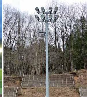
LED投光器は14m高さの照明柱に設置
