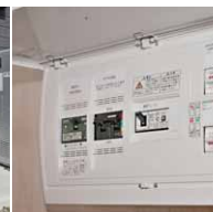
非常時使用する蓄電システム用分電盤
