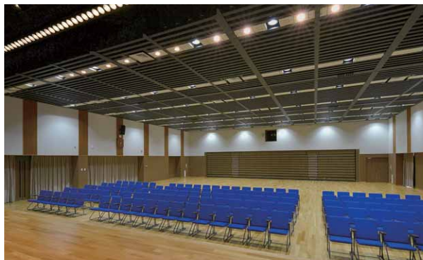
舞台側から客席を望む。手前からLEDボーダーライト、LEDユニバーサルダウンライト、客席用のLED一体形ダウンライト
